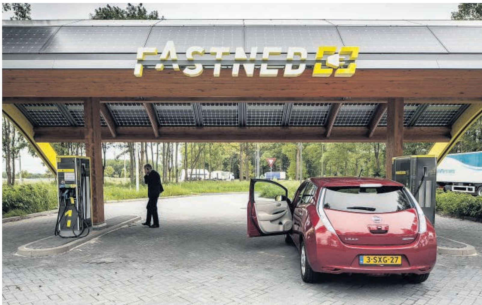
Elektrische auto bij een snellaadstation aan de A28 in Drenthe.
